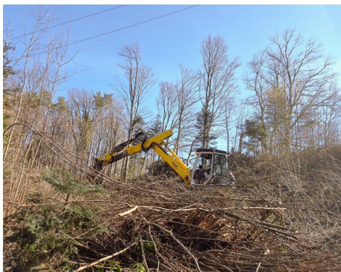
Naturschutzarbeiten – hier Arbeiten am IWB-Leitungsprojekt Schattenberg in Liesberg Kleinlützel – sind im Forstrevier Laufental-Thierstein West ein wichtiger Umsatzpfeiler.
